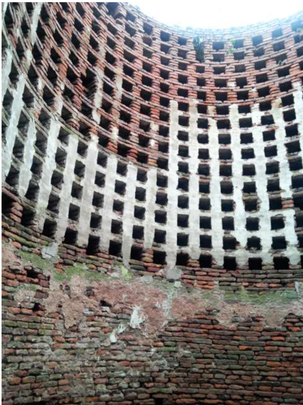
Figura 3: Pared cilíndrica del palomar de La Postrera; nótese que los nichos comienzan a cierta altura evitando el metro inferior.
