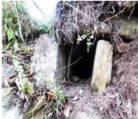
Figura 07: Ducto de drenaje, ubicado en el sector bajo de la Cuenca del Cocahuayco, Bongará Amazonas.
